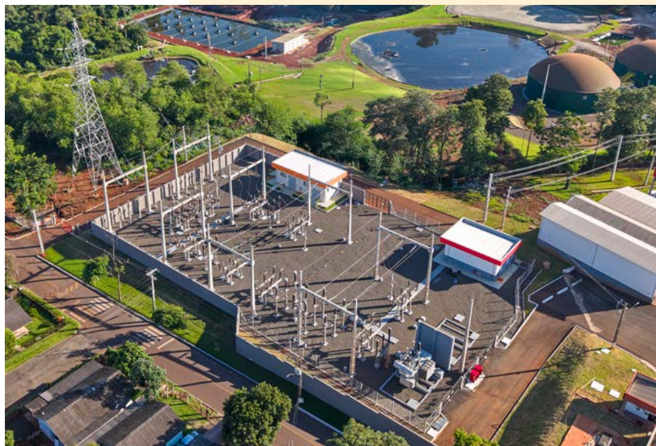
SUBESTAÇÃO de Energia 138 kV de Medianeira.
